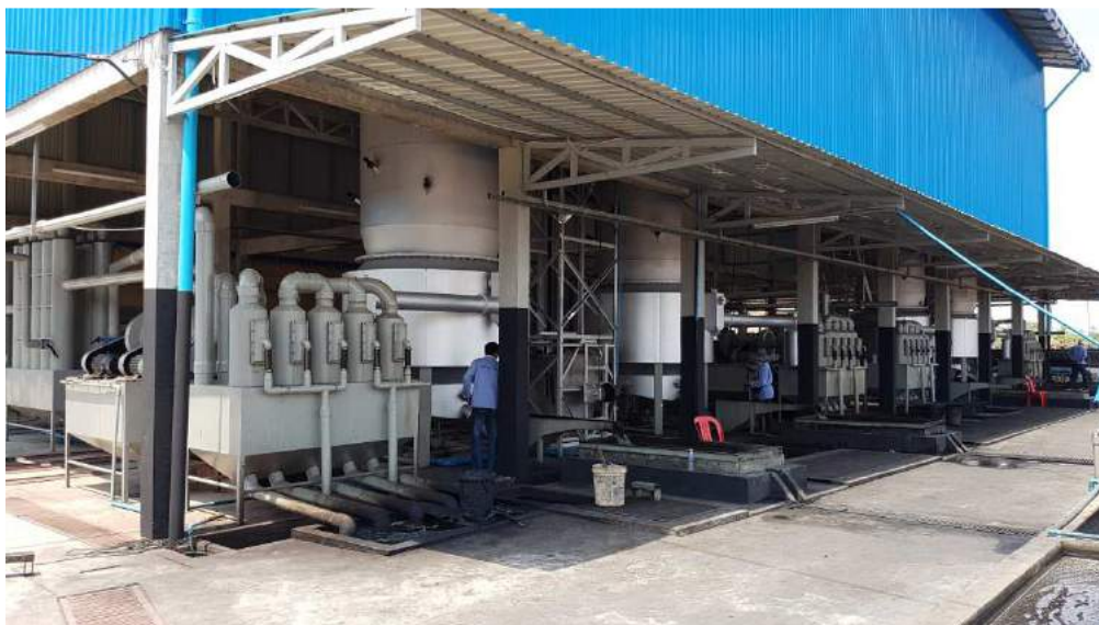
Figure 4 : Exemple de centrale gazéification (Sra Em, Cambodge, 1 MWe)
