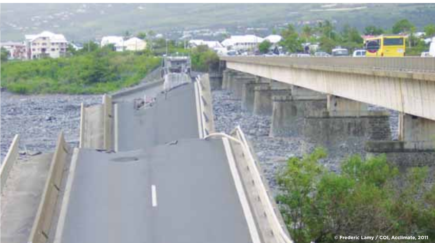
L'eau, force destructrice (St Louis, La Réunion)
